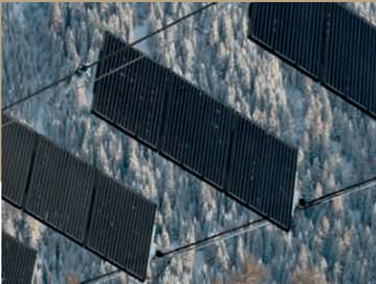
Abb 61: Solarwing mit drei Photovoltaikmodulen (Quelle: Solar-Skilift, o. J.)
