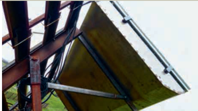
Abbildung 3: Bei der Versuchsanlage in St. Antönien sind die Solarmodule an den Rostbalken befestigt. Die Solarmodule überragen den Stützrost nicht und haben einen genügend grossen Bodenabstand. (Bild: S. Margreth; Projekt: energiebüro ag/Zürich/Schweiz – für Solarkraftwerke)
