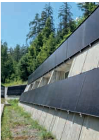
Abb 6: PV-Module Tunnelportal Trin
