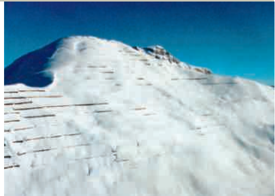
Abbildung 4: Lawinverbauung Chüenihorn in St. Antönien im Februar 1999. Zahlreiche Werkreihen sind überschneit und Lawinabgänge sind sichtbar. In dieser Situation wären Schäden an auf Stützwerken befestigten Solarmodulen mit grosser Wahrscheinlichkeit aufgetreten. (Bild: SLF)
