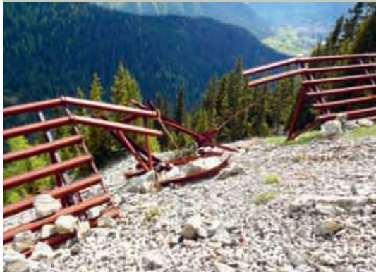
Abbildung 5: Stützwerke wurden 2013 durch Stein- schlag stark beschädigt respektive zerstört. Ein sol- cher Standort ist trotz der Südlage für das Erstellen eines Solarkraftwerkes nicht geeignet.
