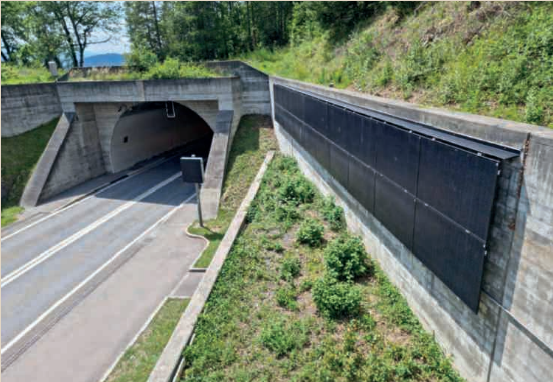
Abb 10: Beispiel für die direkte Nutzung der vor Ort erzeugten Energie am Tunnelportal Trin (Solpic.ch, o. J.)
